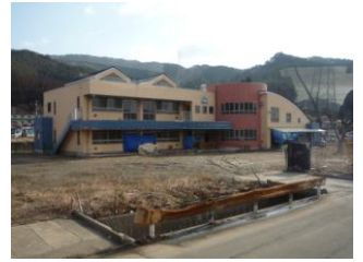
みどり幼稚園被災園舎
